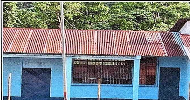
Foto 2: Se observa el deterioro del techo y bigas por la polilla en el módulo 2.
