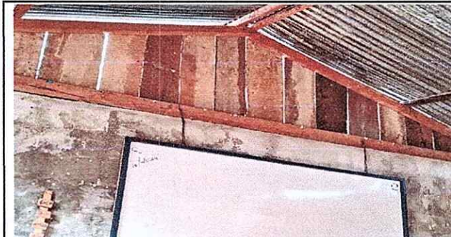
Foto 4: Filtración de agua y paredes expuesta a la humedad módulo 3.
